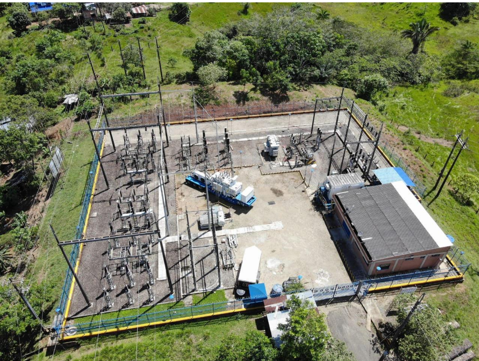
Subestación Caicedo, EEBP E.S.P. S.A. – Puerto Caicedo.
